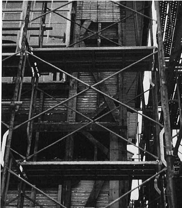
写真 11 腰折れの筋違（過去の修理写真）
