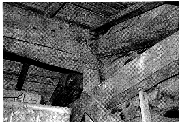
39 改修前 納屋 小屋組接合部
